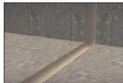
La nappe VEDAFEU SV ® est en place.
